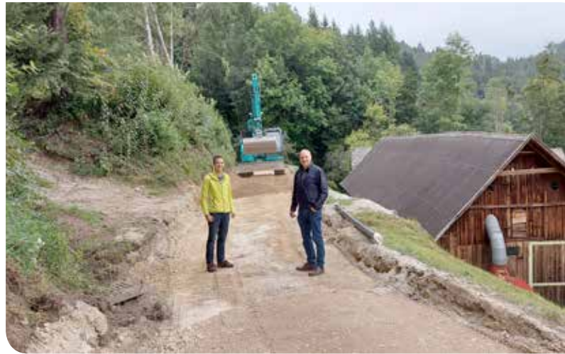
Ing. Michael Rosenberger, Abteilung Güterwege des Amtes der NÖ Landesregierung, und Vizebürgermeister Hubert Haselbacher überzeugen sich vom Arbeitsfortschritt am Güterweg Kirchgraben.
